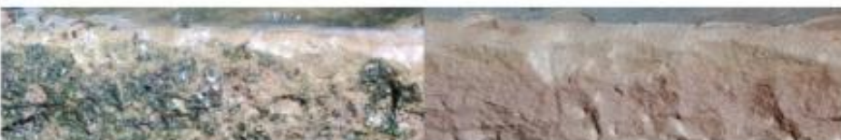
Entfernung von Veralgungen und Moos an Sandstein
