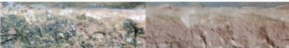
Entfernung von Veralgungen und Moos an Sandstein
